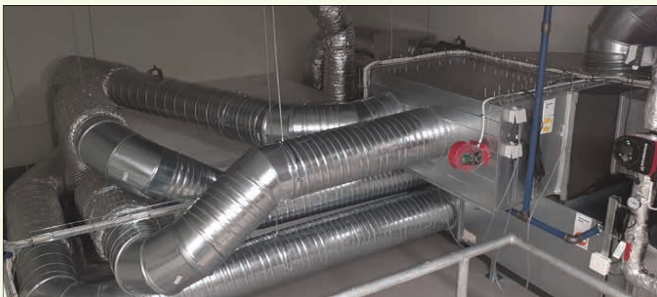
Figur 14. Utsnitt av ventilasjonssystem med ventilasjonsaggregat. Foto: Jens Tønnesen.
